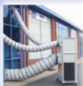
Installation extérieure avec gaines de soufflage et d'air process.
