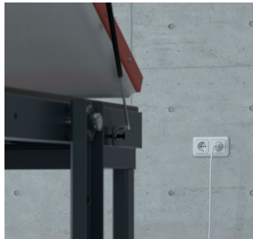
230 V Energieversorgung 230 V power supply
