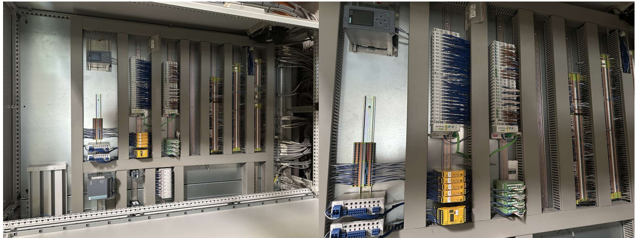
SPS-Feld – Siemens S7-1500, SITOP, Sicherheitsrelais und ET 200-Baugruppen
