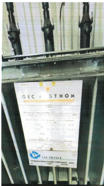
Photo IX La plaque d'identification du transformateur GEC-ALSTHOM
