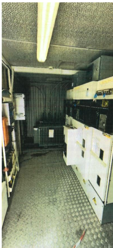
Photo VII Le poste de commande
