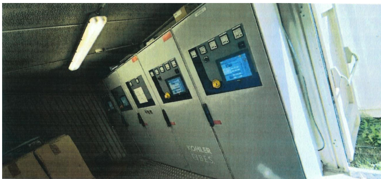
Photo VIII Autre vue de la salle de commande et contrôle
