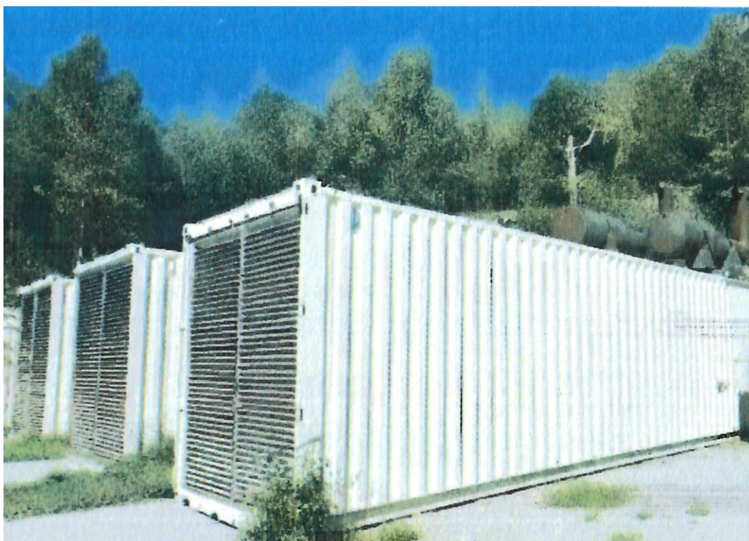
Photo I Trois groupes électrogènes de secours en conteneur
