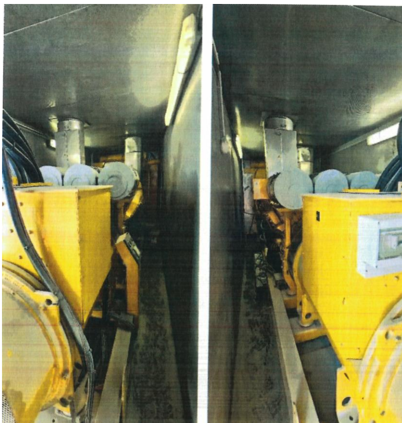
Photo III Vue des groupes CUMMINS - LEROY SOMER
