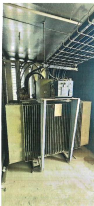
Photo IV Le transformateur 400 [V] / 20 [kV]
