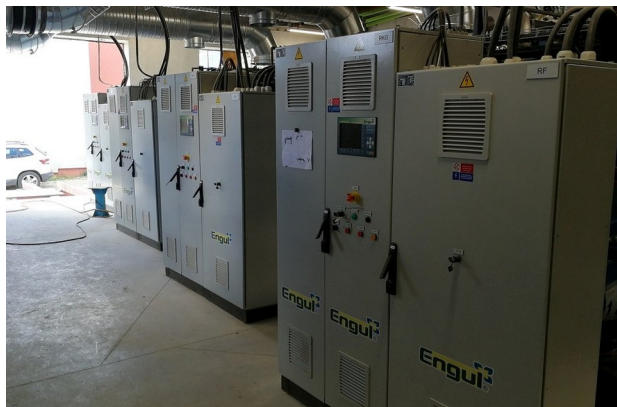
Řada rozvaděčů / řízení
