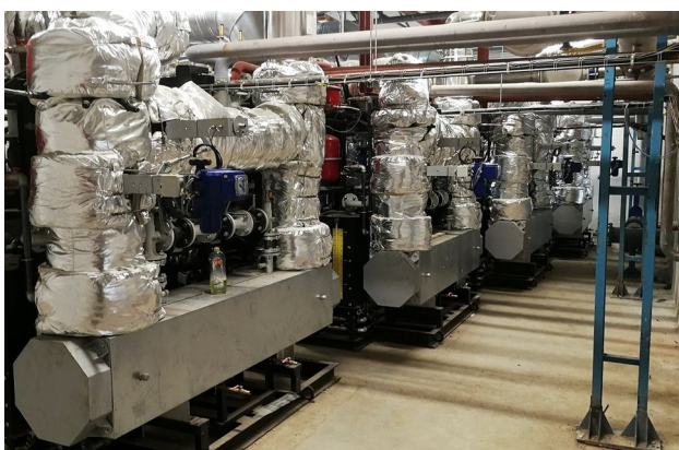
Rekuperace tepla a potrubní technologie
