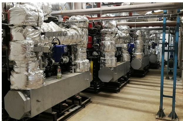
Rekuperace tepla / potrubní rozvody
