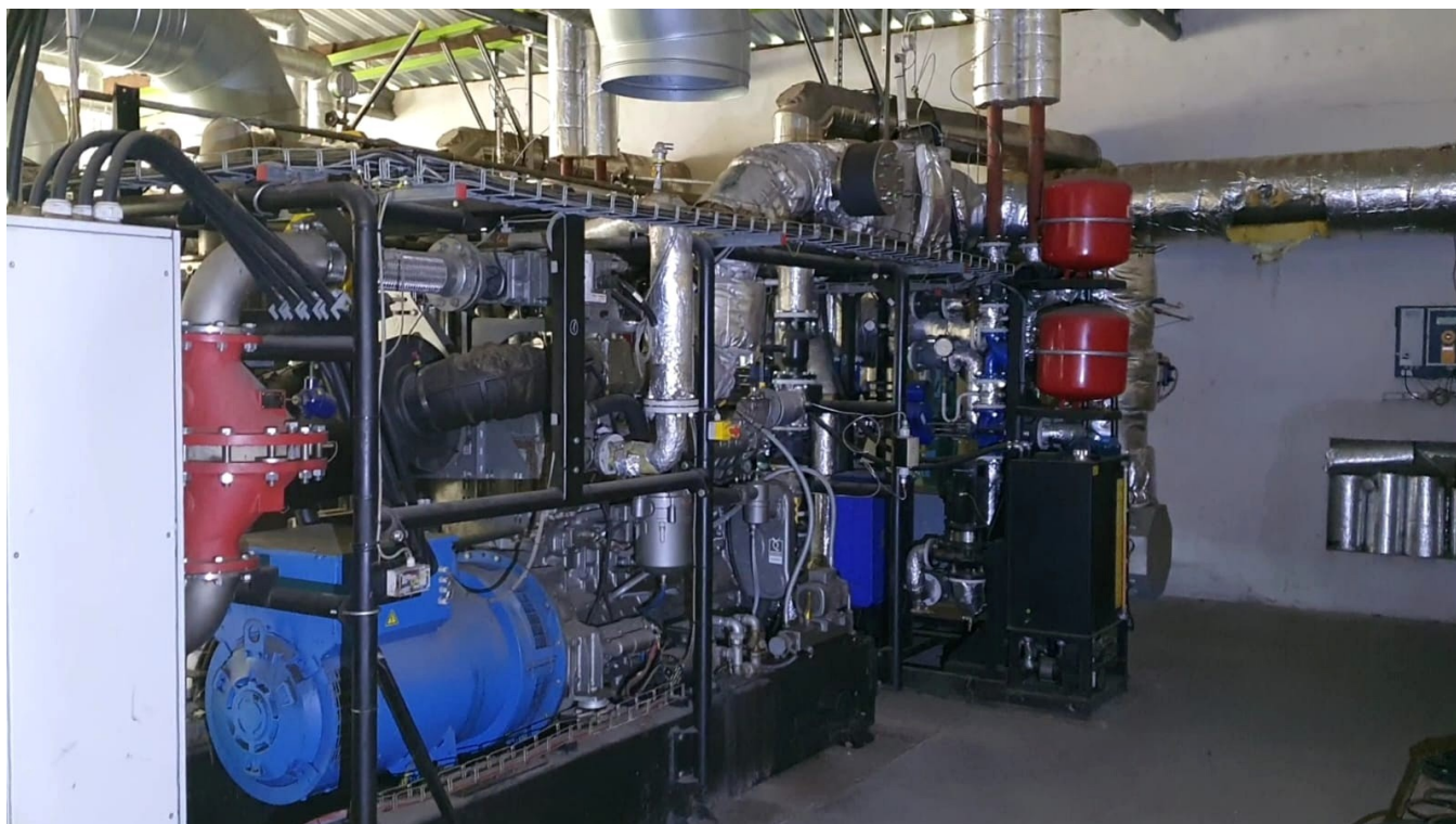
Obrázek: stávající kogenerační jednotky v provedení Open Skid ve strojovně
