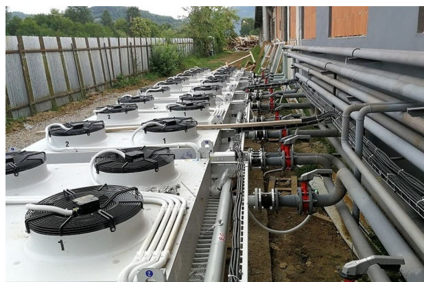
Außen aufgestellte Rückkühler
