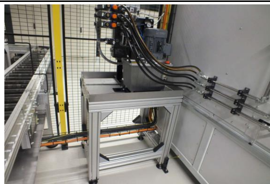
Ansicht Hydraulikaggregat für Spannvorrichtungen
