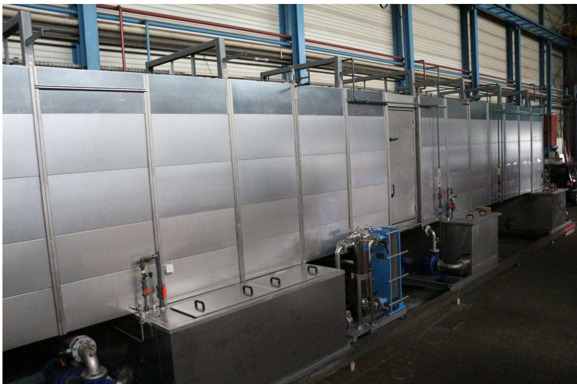
Tunnel mit den Becken von Zone 1 - 3
