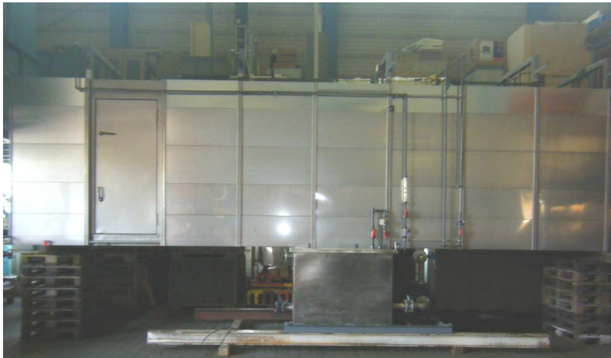
von links nach rechts Zone 4 mit Auslauf und VE-Sprühkranz und Kaskade nach Zone 3
