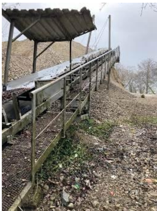
Fig. XXIII Vue oblique du convoyeur avec plateforme pour récupération incinérables et aciers par un opérateur
