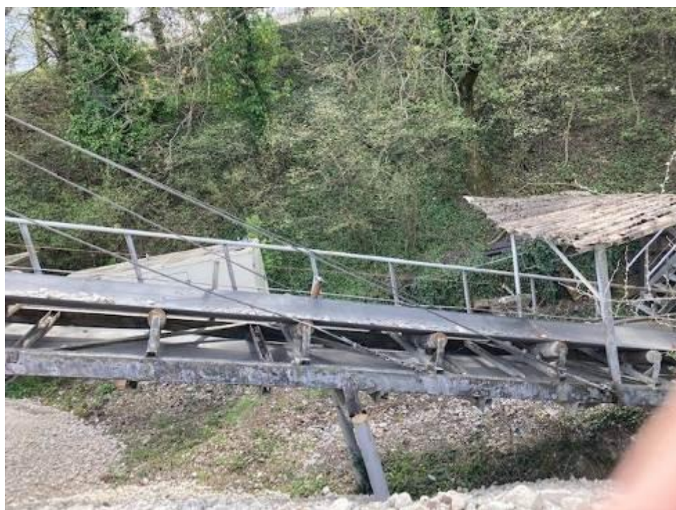
Fig. XXV Vue tronçon intermédiaire du convoyeur de stockage
