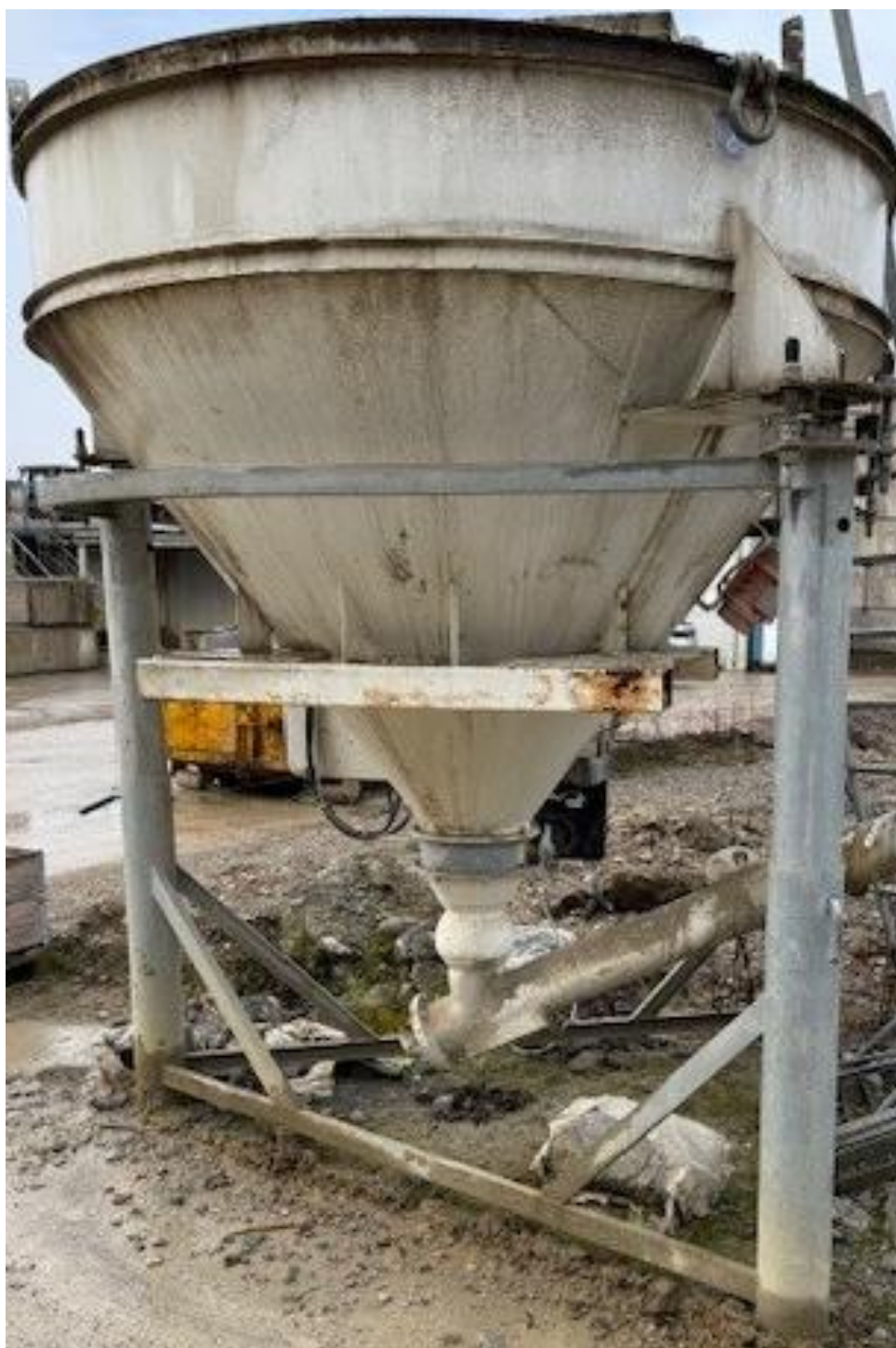
Photo I Vue silo et départ vis à ciment
