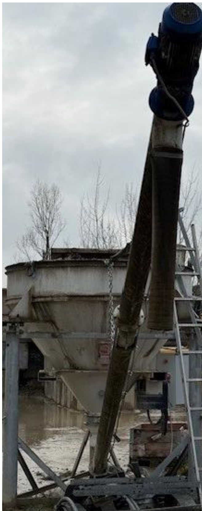
Photo II Silo à ciment doseur
