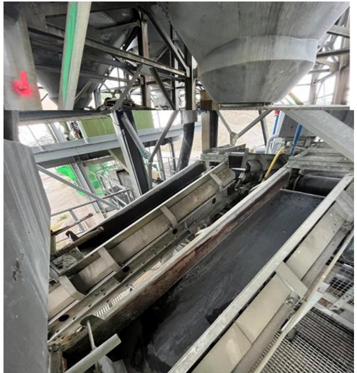
Abbildung 12 Dosierbänder unter den Feinsandsilos
