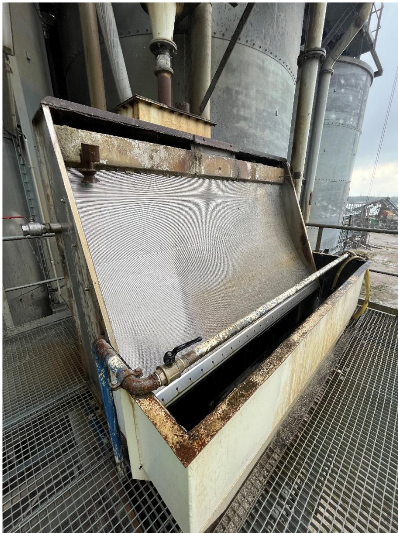
Abbildung 5 Bogensieb der Feinsandrückgewinnung
