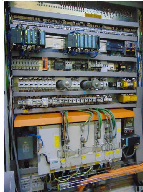
Schaltschrank offen (electrical cabinet open)
