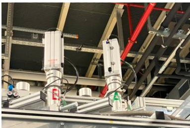
Materialpuffer für Taktzeitneutraler Fasswechsel
