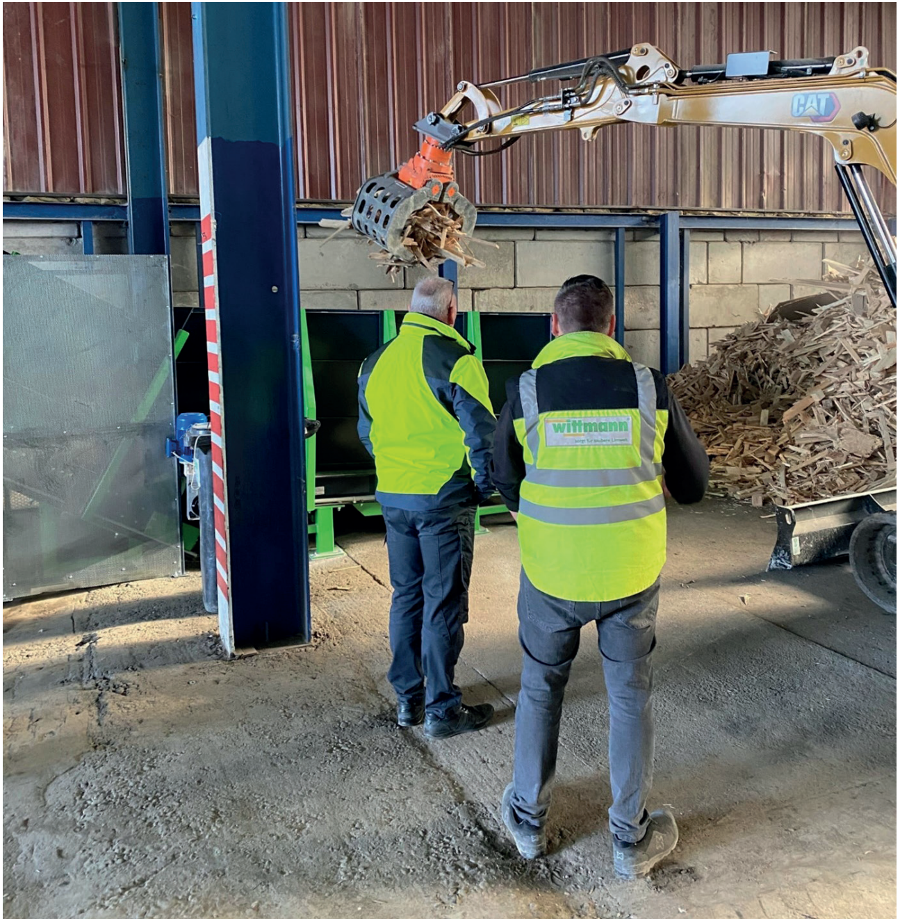
Abbildung 3: Bagger befüllt den grünen Materialbunker der Anlage mit Altholz.
