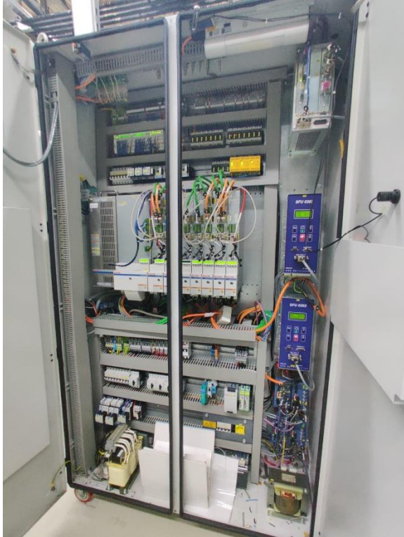
Schaltschrank (geöffnet) (electrical cabinet (open))
