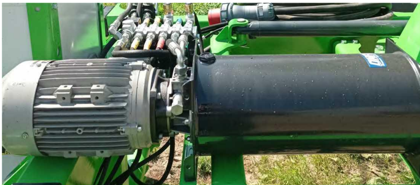
(Obr. 19. - Čerpacia hydrocentrála a elektromotor)
