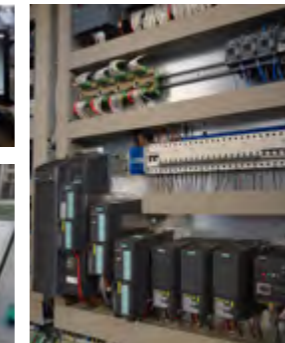
Elektrik Ünitesi Electrical Unit
