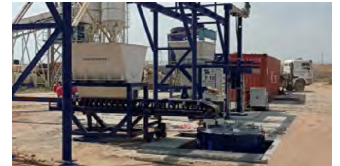
Nijerya - ZIM T 1015 Beton Baca Üretim Tesisi Nigeria - ZIM T 1015 Concrete Manhole Production Facility
