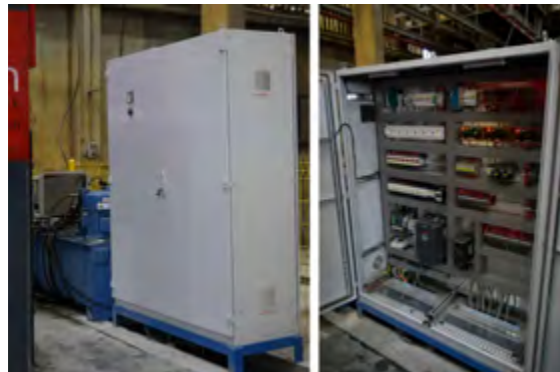
Elektrik Ünitesi Electrical Unit
