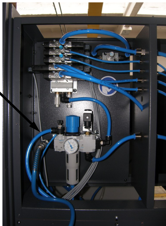
Anschluss der Druckluft
