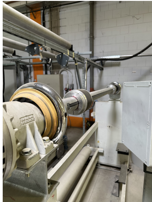
Lager-/Antriebsseite mit Spannrolle und Kupplung
