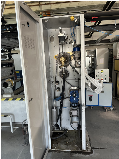
Geöffnete Antriebsseite mit Ketten, Getrieben und Drehdurchführungen
