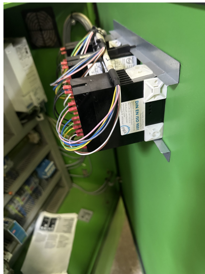
Abb. 7 – Regler-/Anschlussbaugruppe an der Schaltschrankschür; kein Typenschild der Gesamtmaschine
