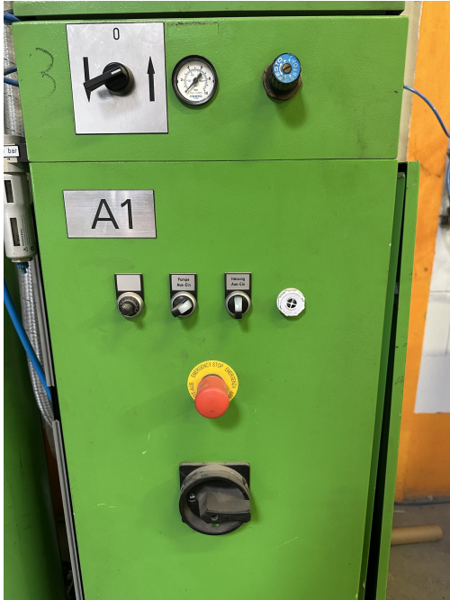
Abb. 5 – Front des Schaltschranks A1
