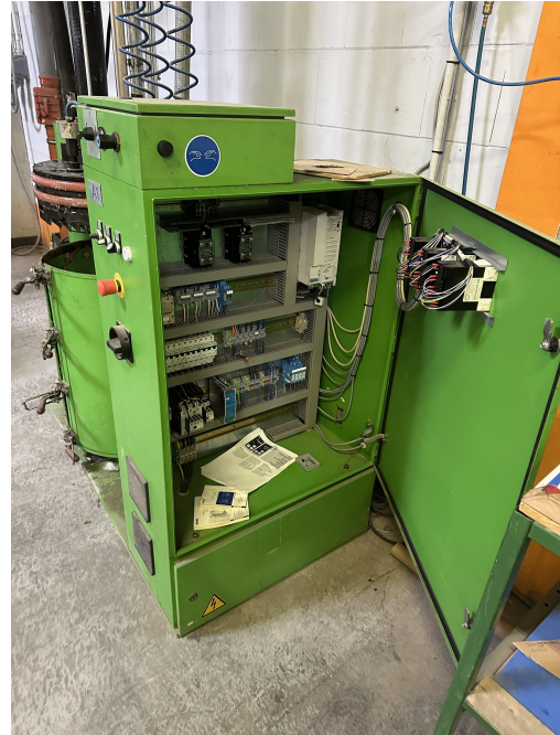
Abb. 6 – Innenansicht des Schaltschranks A1
