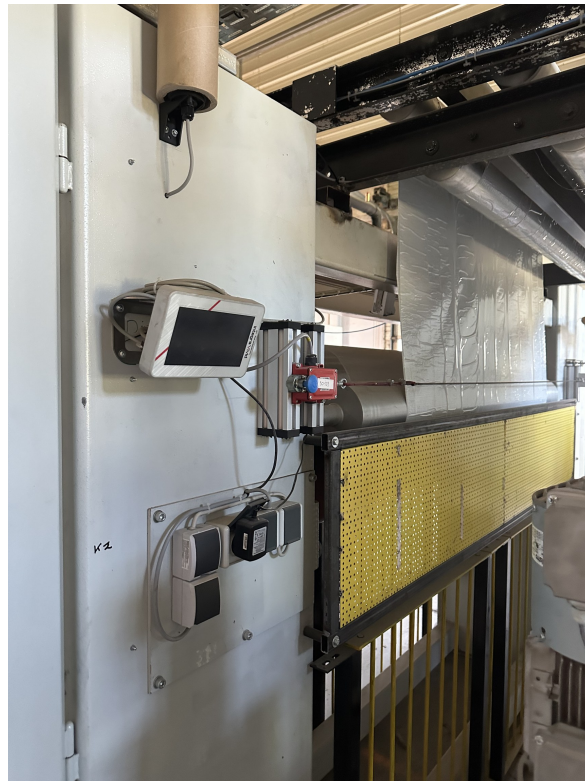
Abb. 8 – Sensorik und Schutzgitter am Einzugs-/Auslaufbereich
