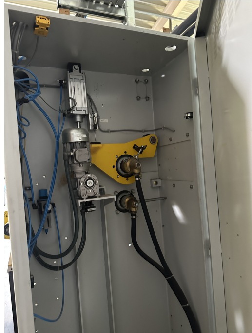
Abb. 7 – zweite Ansicht der Antriebsseite mit Motor/Getriebe und Medienleitungen
