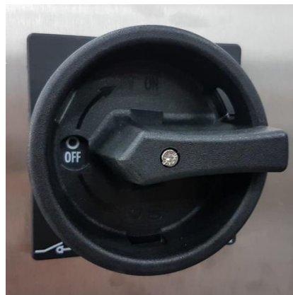
Figuur 1.3 Voorbeeld van een hoofdschakelaar in de O-/ Uit-positie.
