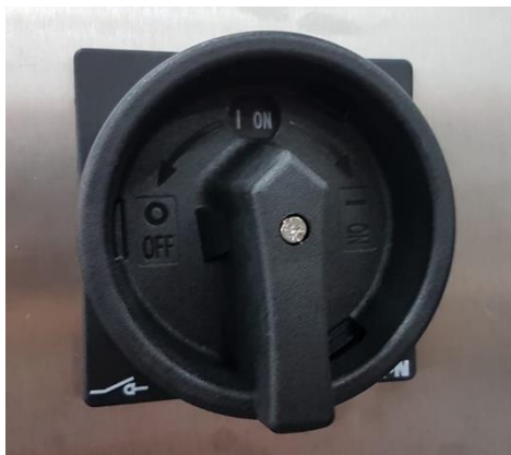
Figuur 1.2 Voorbeeld van een hoofdschakelaar in de I-/ Aan-positie.
