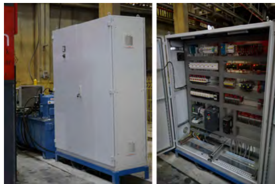
Elektrik Ünitesi Electrical Unit
