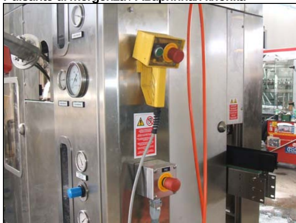
Pulsante di emergenza / Аварийная кнопка
