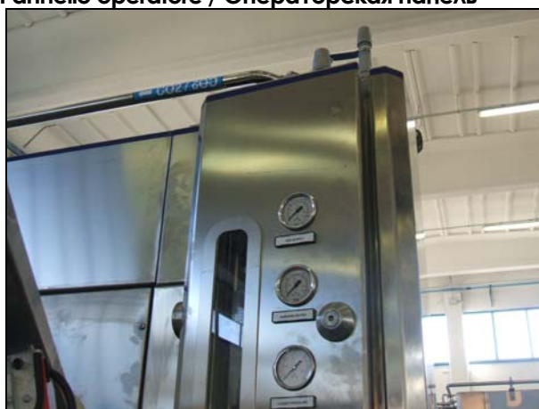
Pannello operatore / Операторская панель
