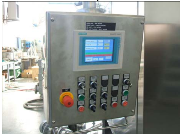
Pannello elettrico / Электрическая панель
