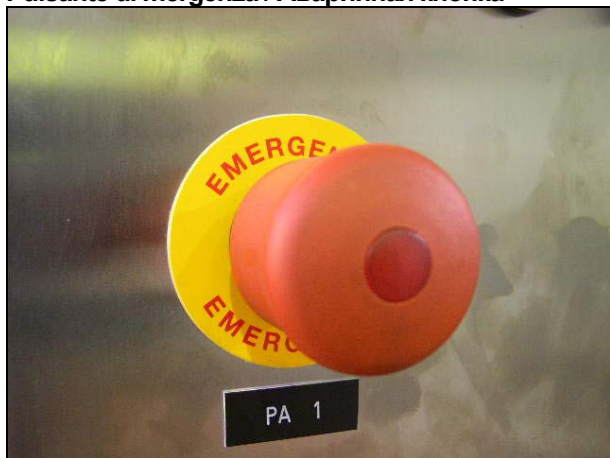
Pulsante di emergenza / Аварийная кнопка
