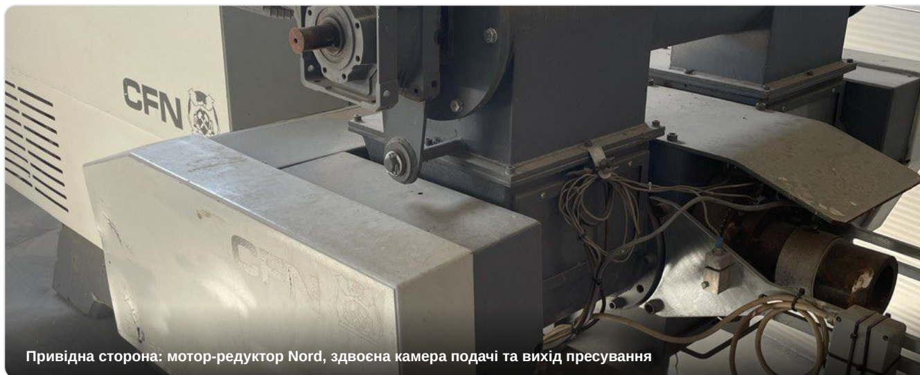
Корпус преса BP 6000 на бетонній основі — CFN
