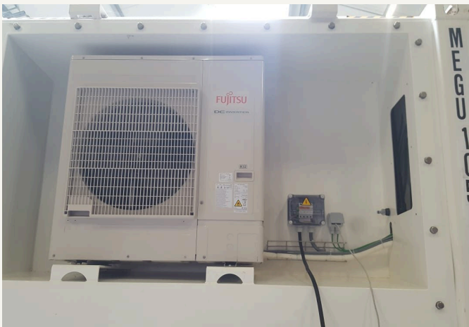
Klimagerät im Vorbau des Containers
