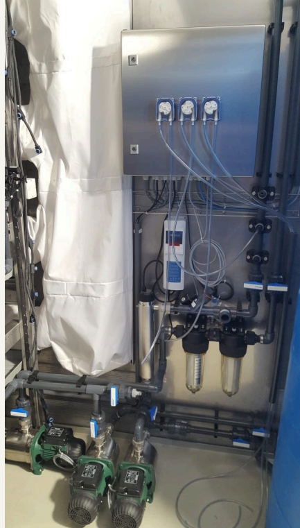
Technikraum: Dosierung, Filter, Pumpen
