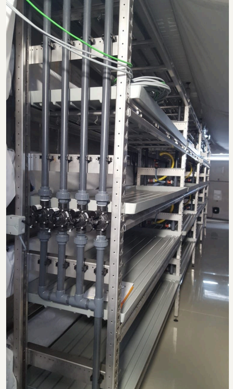
Ventile und Leitungen je Anbauebene
