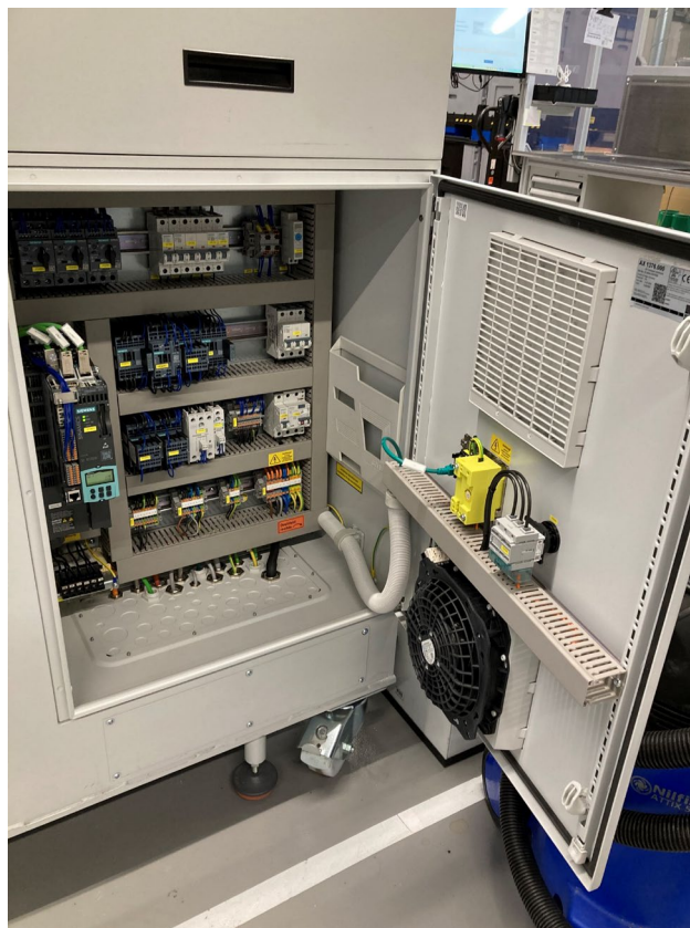
Schaltschrank (switch cabinet)
