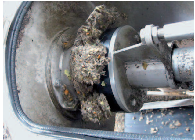
Austrag der ausgesiebten und verdichteten Fremdstoffe
