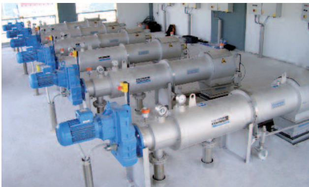
Schlamm-siebung auf der Kläranlage Athen / GR
