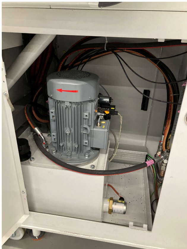
Hydrauliksystem (hydraulic system)
