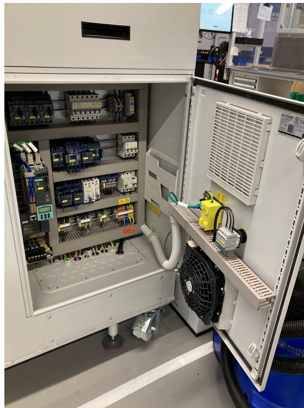
Schaltschrank (switch cabinet)
