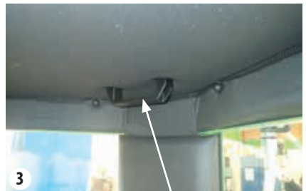
Handgriff der Dachluke
